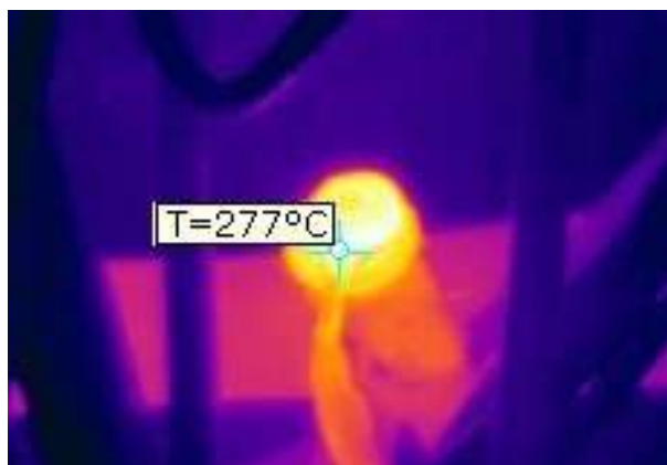
Рисунок 22. Пример обнаружения пожароопасного разогрева болтового контактного соединения
