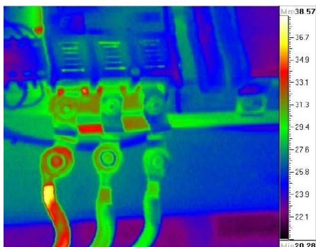
Рисунок 21. Пример термограммы контактных соединений с температурной шкалой
